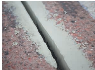
Die Fahrbahnfugen grundierten die Verarbeiter mit Wecryl 123, danach wurde der Wecryl 846 Betoninstandsetzungsmörtel zur Reprofilierung eingesetzt.
