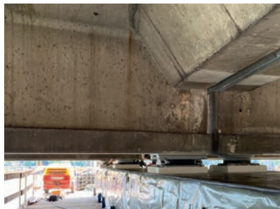
In mehreren Teilabschnitten wurden an neun Achsen und einem Widerlager insgesamt ca. 600 m 2 beschichtet.
