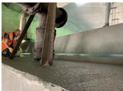
Aufgrund der idealen WestWood Materialeigenschaften wurden die kleinteiligen Oberflächen abschnittsweise in kürzester Zeit fertig gestellt.
