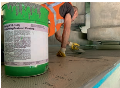
Zur Erhöhung der chemischen und mechanischen Widerstandsfähigkeit wurde die benzinständige Nutzschrift Wecryl 418 appliziert.
