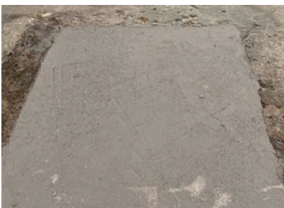
Auch bei kalten Temperaturen war die Grundierung nach 30 Minuten überarbeitbar – die Reprofilierung mit dem BIS-Mörtel Wecryl 885 folgte direkt.
