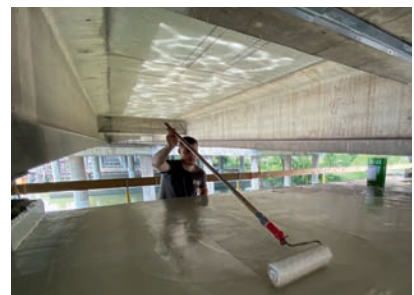
Die Oberseiten der Riegel erhielten eine elastische Oberflächenschutzschicht (hw0) mit der rissüberbrückenden Verlaufsbeschichtung Wecryl 271.
