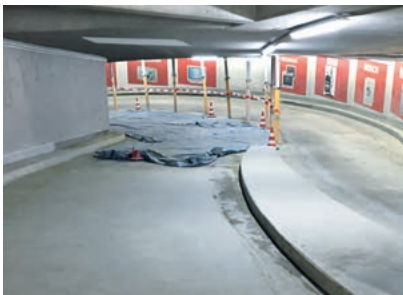
Die 400 m 2 große Rampe zur Tiefgarage erhielt zunächst einen neuen tragfähigen mineralischen Untergrund.
