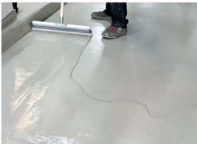
Die Fachverleger brachten die Dichtungsschicht (hw0) in zwei Arbeitsgängen ein. Dabei konnten sie auf eine Vliesarmierung verzichten.
