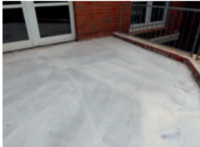
Die schnellhärtende Grundierung Wecryl 276 bildete auf dem geschliffenen Estrich die Basis für die nachfolgende Abdichtungsschicht.
