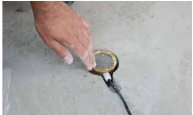
Sensoren Die Sensoren zum Abgleich der Umgebungsbedingungen werden waagrecht und oberflächenbündig in den Untergrund eingesetzt, der Zuleiter angeschlossen
